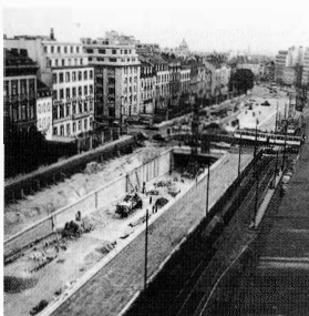
Het graven van tunnels onder de kruispunten (hier dat van de Wetstraat) was een noodzakelijke voorwaarde voor de heraanleg van de ringlanen in stedelijke autosnelwegen, zoals beslist in het vooruitzicht van de Expo '58.
